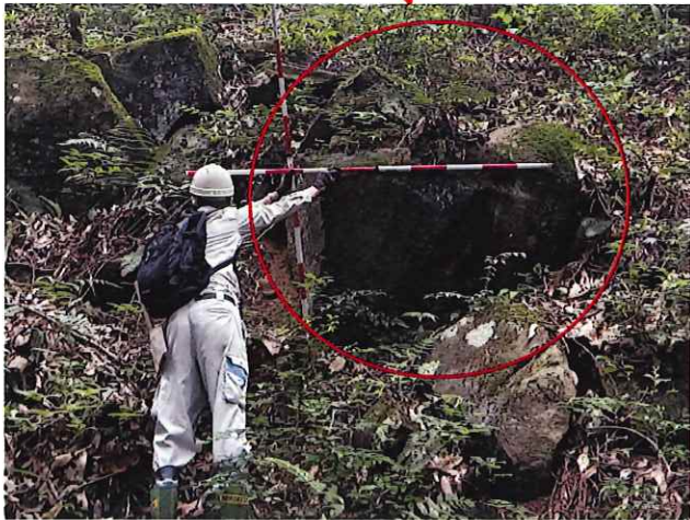
写真3 要対策の浮石の大きさ 横1.2m、縦1.0m 基部が凹状態
