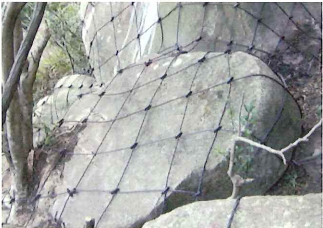
写真4 ロープネット工施工例
