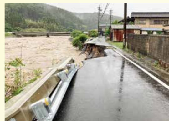
(令和5年6月豪雨 釜戸町県道崩落箇所)
