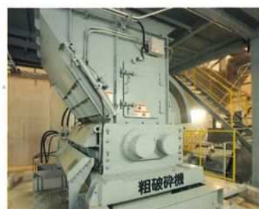
■粗破砕機 ゆっくりと回転する刃でゴミを大まかに破砕し、その後の処理をスムーズにします。
