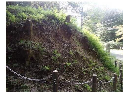
図 11 奥之田一里塚 洗堀状況
