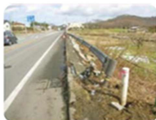
ガードレール・ 標識等の損傷
