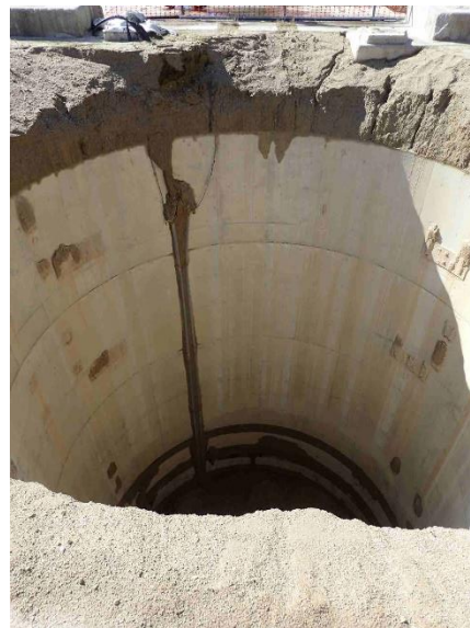
2023/11/08 総沈下量 10.5 m
