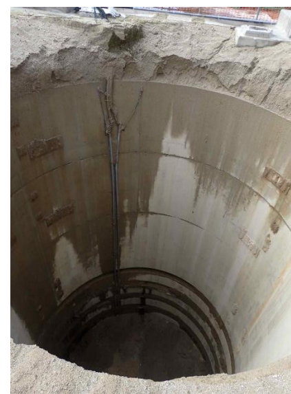
2023/11/13 総沈下量 12.7 m
