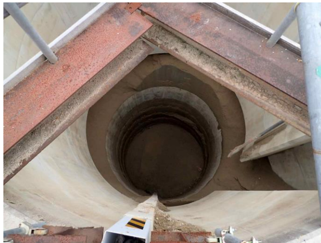
2023/11/06 総沈下量 13.7 m
