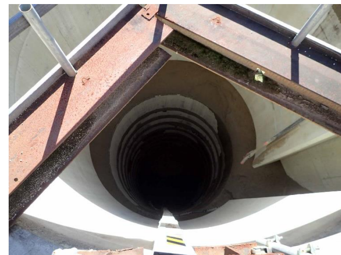
2023/11/08 総沈下量 21.6 m
