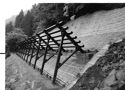
なだれ防止柵工
