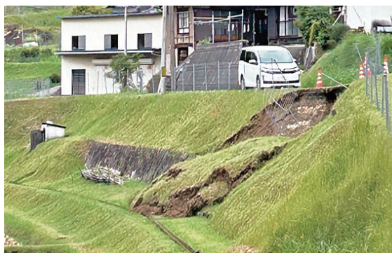
豪雨により崩落した法面
