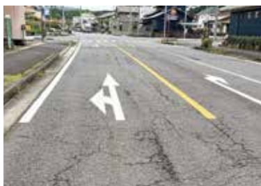
変状が著しいアスファルト舗装
