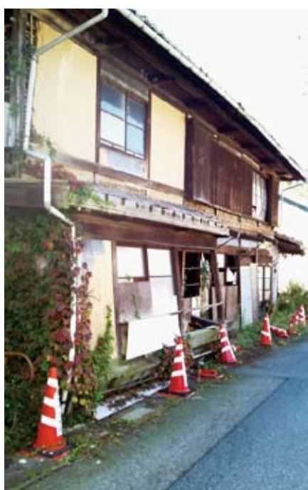
危険な状態の空き家
