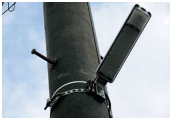
LED 化された防犯灯
