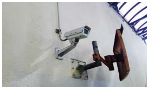
監視用防犯カメラ
