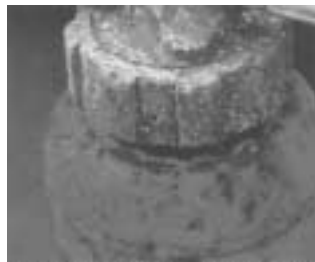
あばた状の腐食
