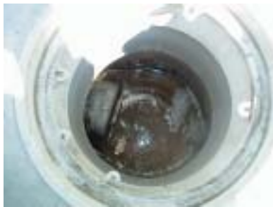
防油ますに蓄積された油
