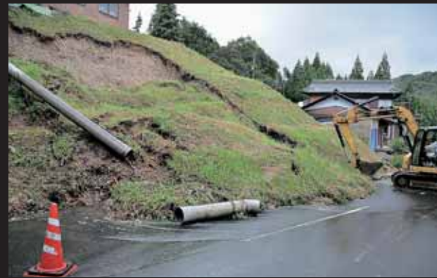
▲地滑りが発生した現場(日吉町)
