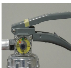
× 安全栓の脱落
