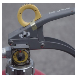
× 表示装置の脱落
